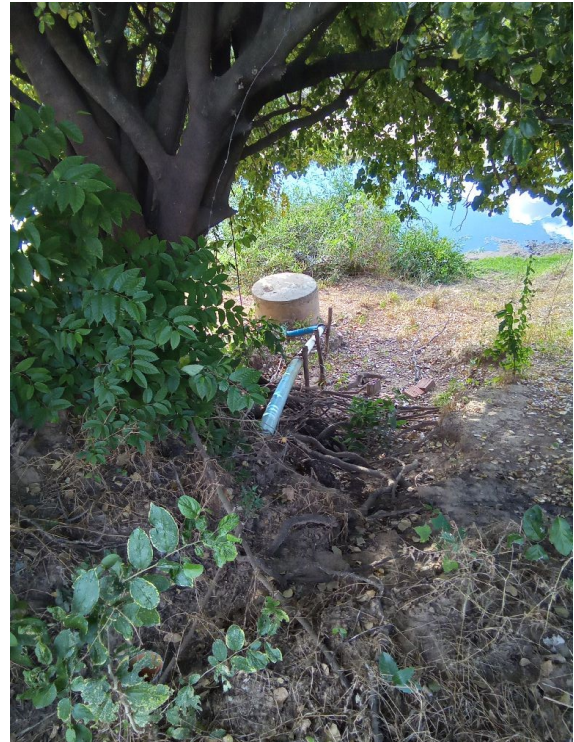
(b) Captação no leito do rio.
